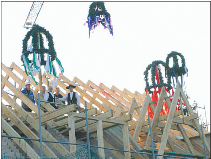
Vier Richtkränze wurden vergangene Woche über dem Neubau der GEWOSIE in der Heinrich-Meyer-Straße aufgezogen.
